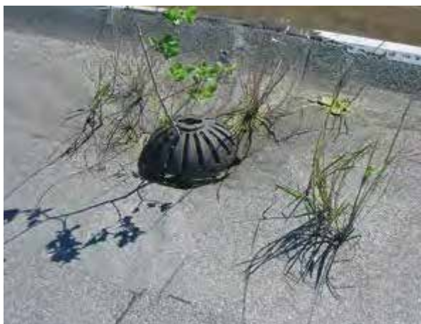
Durchwurzelung durch Rhizome
